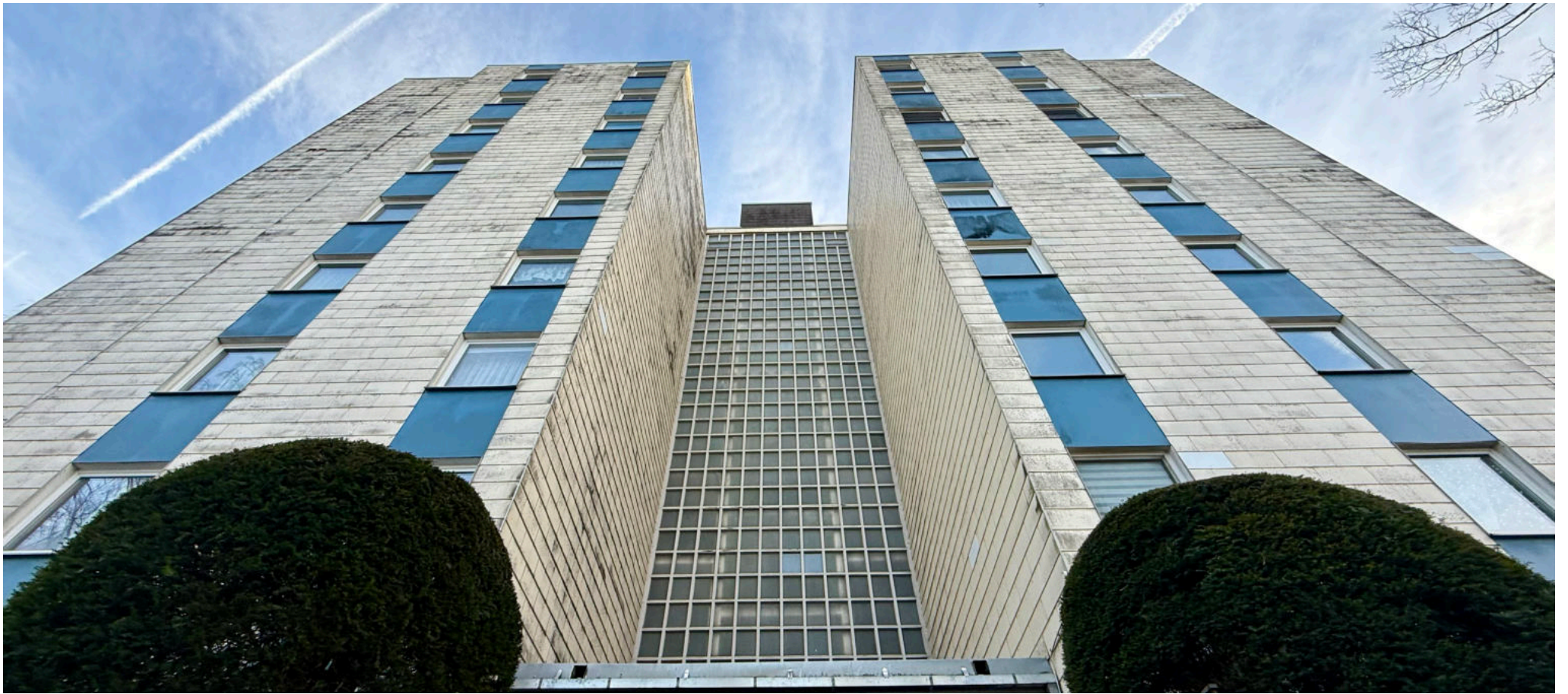
Die Wohntürme an der Innsbrucker Straße: Marode Fassade, ungewisse Zukunft. Symbol für Spekulation und fehlenden Mieterschutz.
